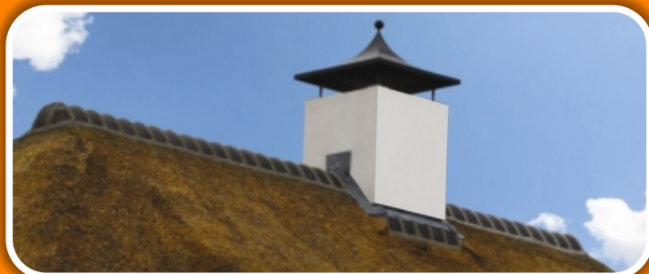
Gestrukte nok-schoorsteen uitgevoerd met sierkap, geplaatst op een rietendak.
